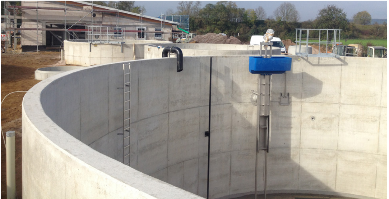
Bild 3: Neues Betriebsgebäude und SBR-Reaktor mit Klarwasserabzug HydroKlar-SLIDE [1]
